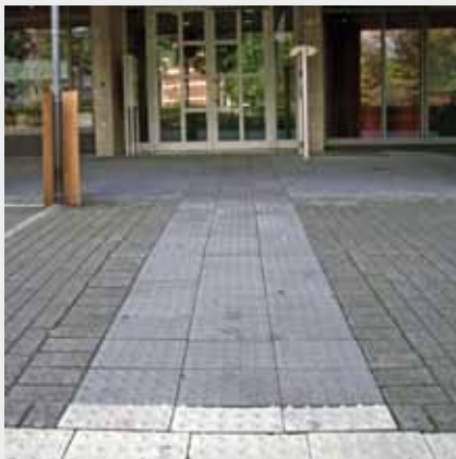
Ein Auffangstreifen, bestehend aus Noppenplatten quer über den Gehweg, weist auf den Eingang hin
