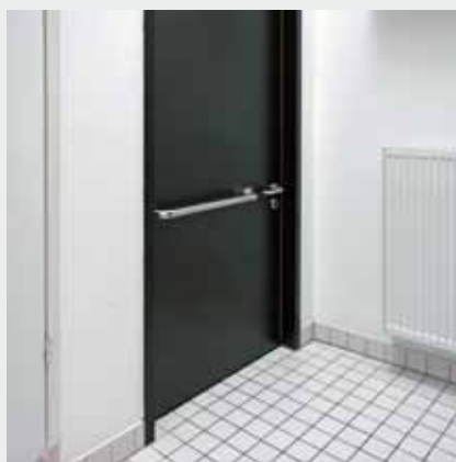
Die Zuziehstange erleichtert Personen im Rollstuhl das Öffnen und Schließen der Tür, der Türdrücker hält jedoch nicht die 50 cm Mindestabstand zur Wand ein
