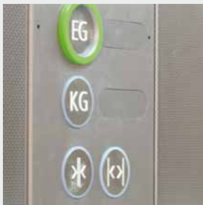
Diese Tasten, darunter die Erdgeschoss-taste (Gebäudeausgang), sind für blinde Menschen gut tastbar
