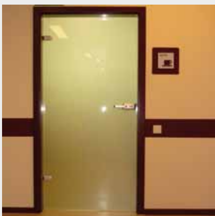
Türzarge, Raumschild und Lichtschalter sind kontrastreich gestaltet, eine kontrastreiche Markierung der Glastür fehlt jedoch
