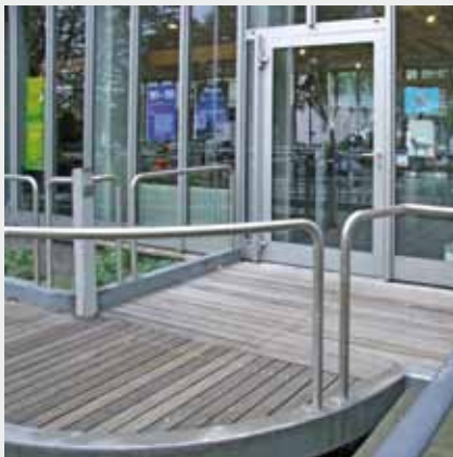
Vor der Tür ist ausreichend Platz für die Betätigung des Türöffners links und zur Begegnung von mehreren Personen mit Rollstuhl oder Kinderwagen
