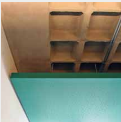
Die abgehängte Decke mindert mit Hilfe von Schalldämmplatten Reflexionen und verbessert somit die Raumakustik
