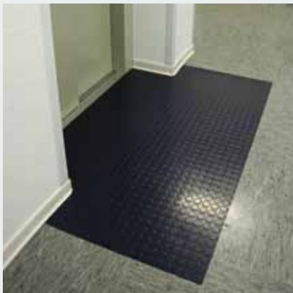
Ein Belagswechsel in Form eines taktil und visuell kontrastierenden Noppenfeldes erleichtert blinden Menschen das Auffinden des Aufzugs
